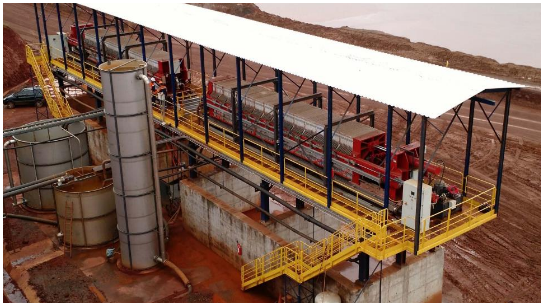
Figura 28. Vista geral da Planta de Filtragem da Mina Casa de Pedra
