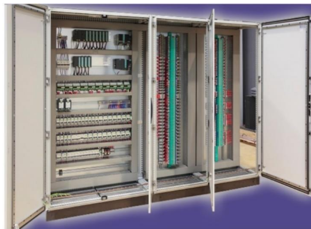
Figura 3: Quadro do Painei do PLC.
