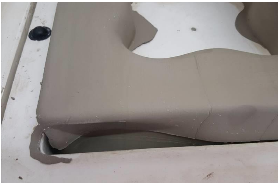
Figura 3.25 – Detalhe de falha na fundição do cobogó (A parede do tijolo se soltou do molde e caiu para dentro da própria estrutura)
