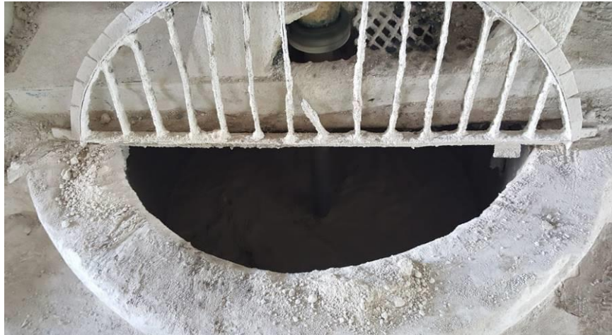
Figura 2.8 – Vista superior de um dos tanques misturadores
