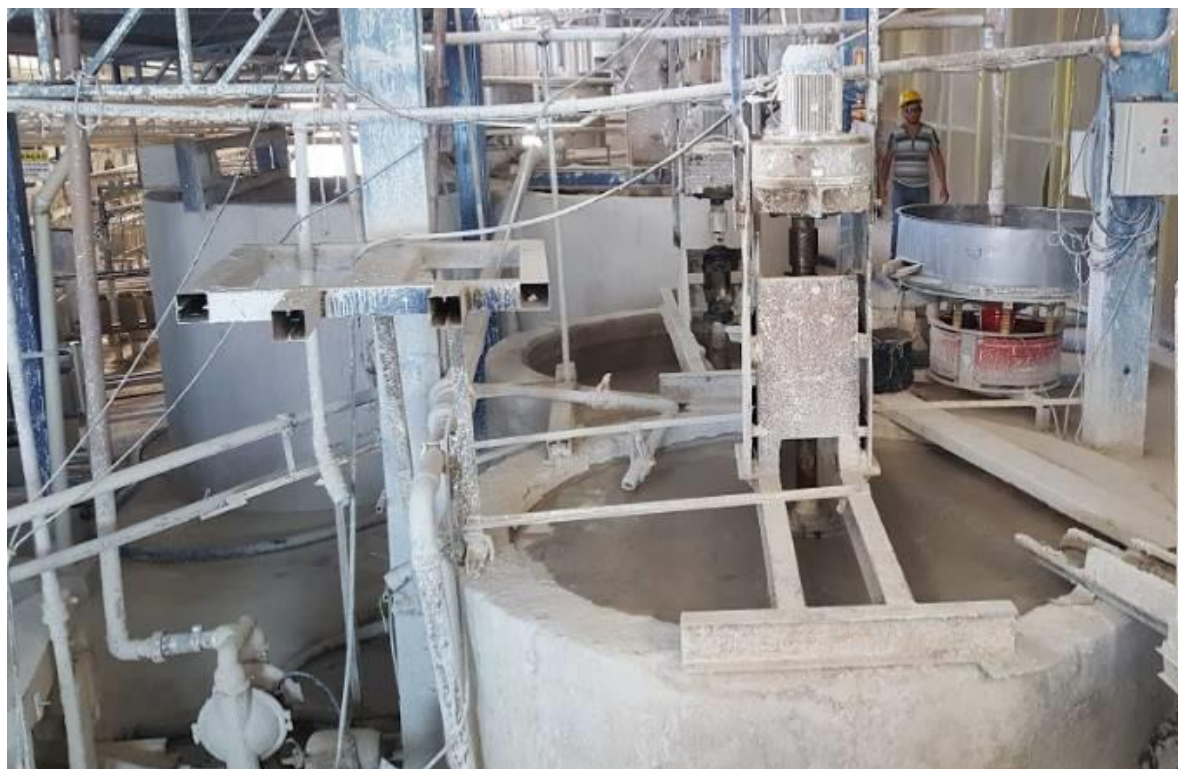
Figura 2.10 – Tanques de acerto e armazenamento da barbotina
